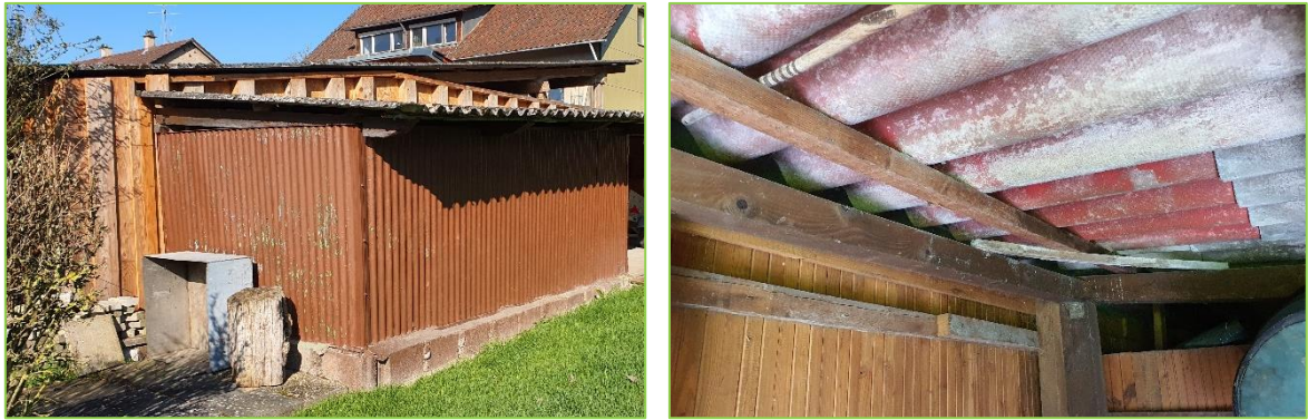
Abb. 4 und 5: Schuppen mit Steinhäufen und Wellplattendach
