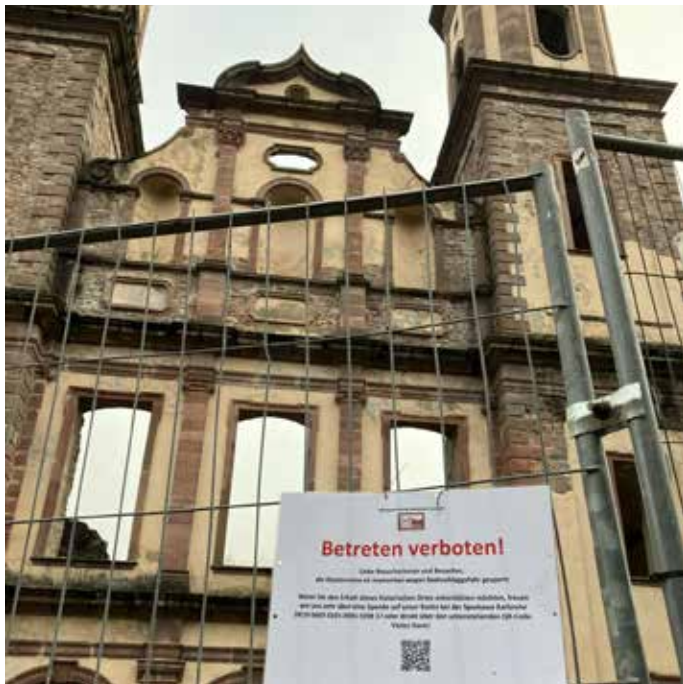
In der Klosterruine Frauenalb sind aufgrund des kritischen baulichen Zustands Notsicherungsmaßnahmen vorgesehen.
